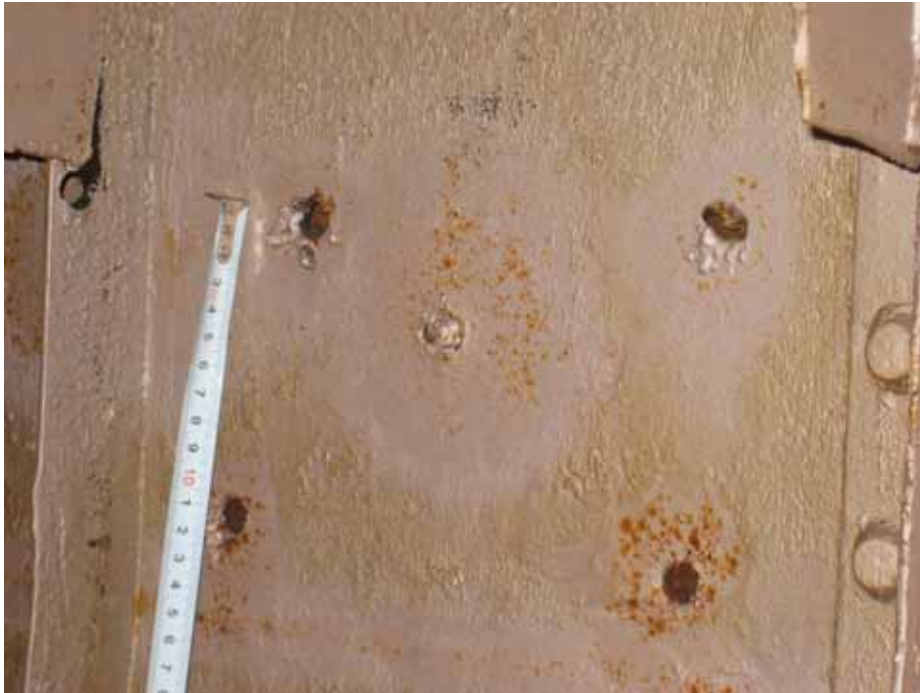
Figuur 6 Afstand tussen de klinknagels van de originele wellingplaat
